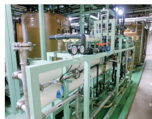
純水製造装置
