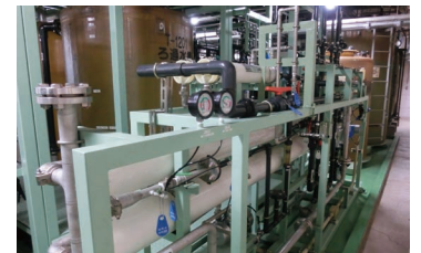
純水製造装置
