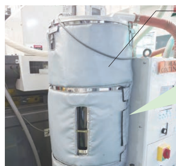
■ 断熱材を設置した材料乾燥機
