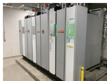
■ 空調熱源用のボイラー
