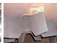
炉内攪拌ファン
