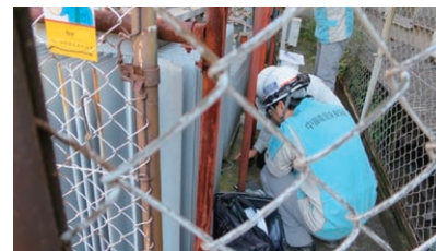
受変電設備点検
