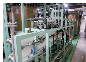
純水製造装置
