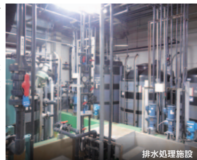
排水処理施設
