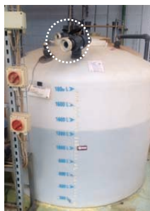
▲蓋に鍵を付けた薬品タンク
