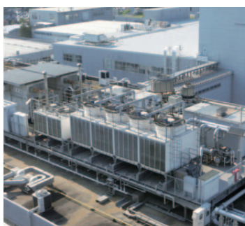
▲本社B-1棟のコージェネレーションシステム
