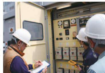
▲受変電設備点検
