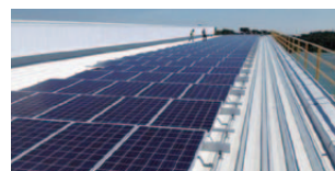
▲50kW太陽光発電装置
