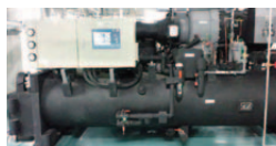
▲インバータターボ冷凍機
