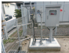
▲雨水監視装置
