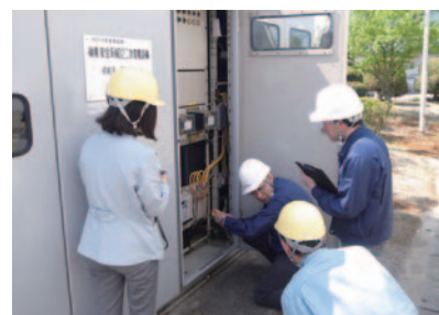
▲受変電設備点検
