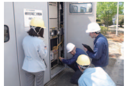
▲受変電設備点検
