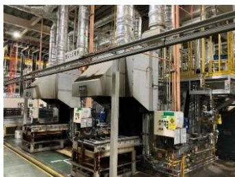
実証実験を行った熱処理炉
