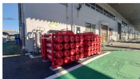
水素供給設備
