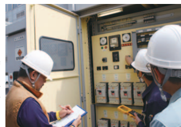
▲受変電設備点検
