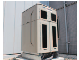
▲蓄電池システム
