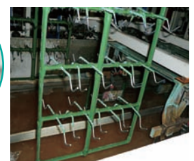
▲脱脂工程 浴槽外観
