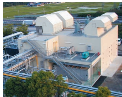
▲音羽工場コージェネレーションシステム外観
