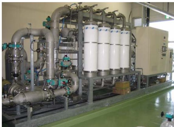
▲工水浄化システム
