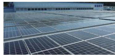
Hagi Plant, Tokai Rika: 0.3 MW
